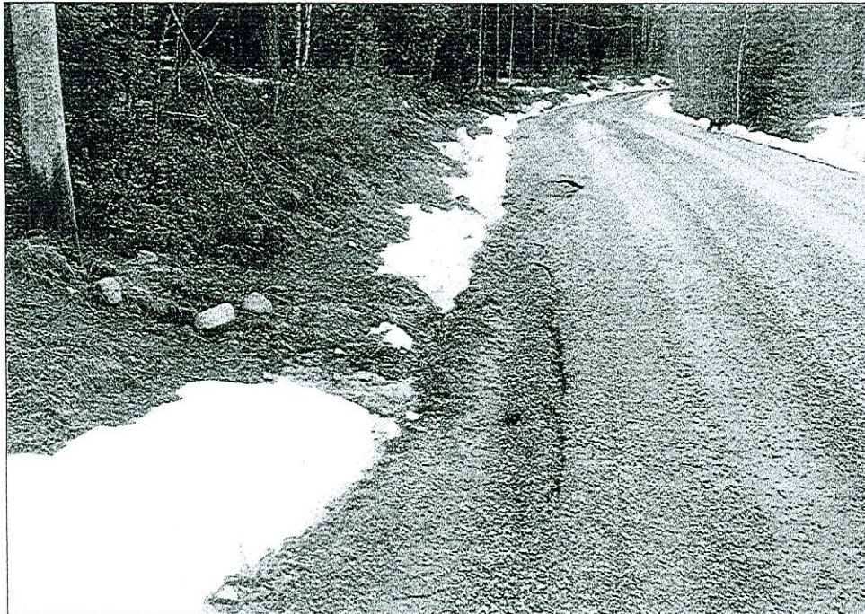
Under menföre är vägens hållbarhet dålig. Märken av tung belastning avslöjar sig under våren lopp, säger vägdisponent Tony Rosqvist i Ingå.
